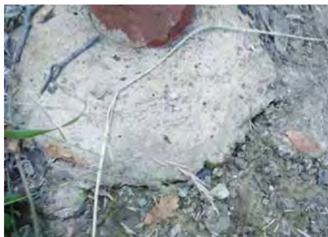
scollamento rilevato nella cementazione testa inclinometro
