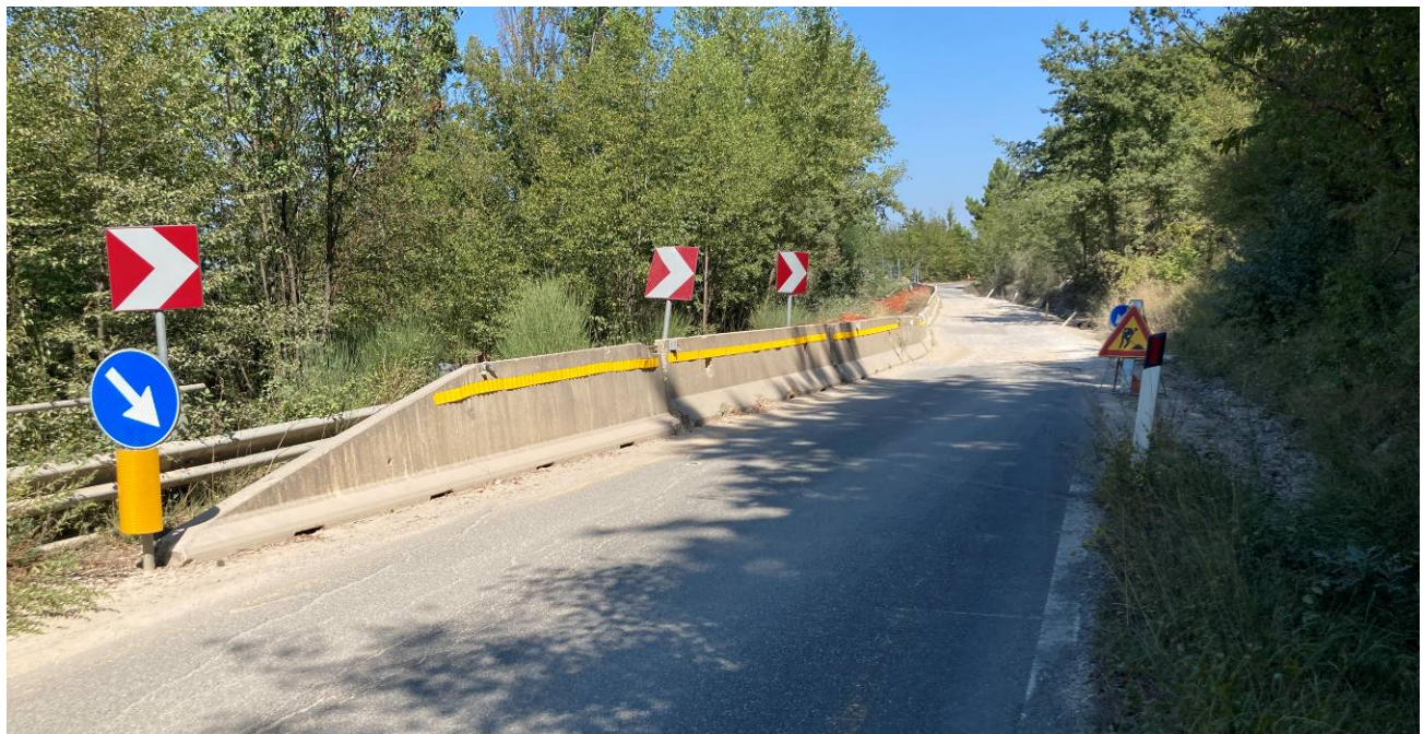
VISTA DELLA SEDE STRADALE COINVOLTA DAL MOVIMENTO FRANOSO
